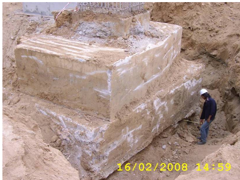
ภาพที่ 32 ฐานรากบางฐานวางอยู่บนหินฟิตส่วนหนึ่งและวางบนดินถมส่วนหนึ่ง อาจทำให้เกิดการบิดตัวของฐานรากจากการทรุดตัวไม่เท่ากัน
