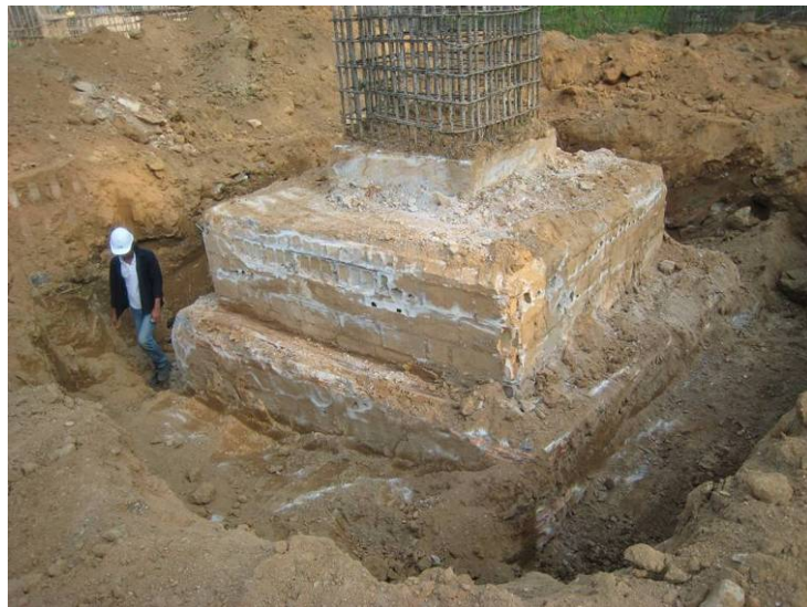
ภาพที่ 31 คอนกรีตรองฐานรากมีความหนามากไป, ไม่สม่ำเสมอ รวมถึงไม่มีการเสริมเหล็ก
