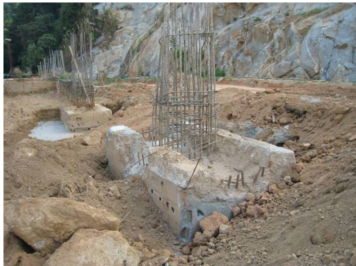
ภาพที่ 30 ฐานรากเก่าพบการเซาะร่องเพื่อวางคานทำให้ Effective Depth ของฐานรากเปลี่ยนไป
