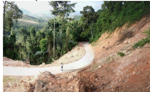
รูปที่ 13 พื้นที่ลาดตัด ทางเข้าออกบ้านหน้าถ้ำ อ.กาญจนดิษฐ์ จ.สุราษฎร์ธานี
