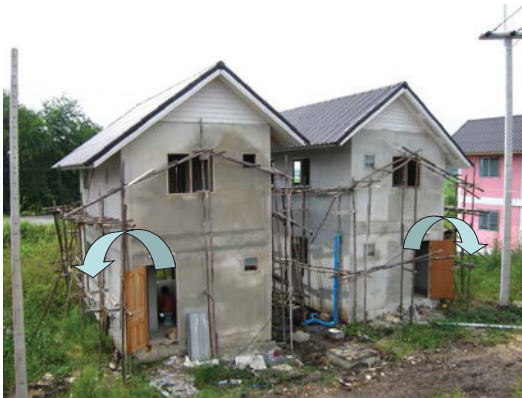
รูปที่ 13 การเอียงของอาคารเนื่องจากเสาเข็มไม่ได้หยั่งถึงชั้นดินแข็ง
