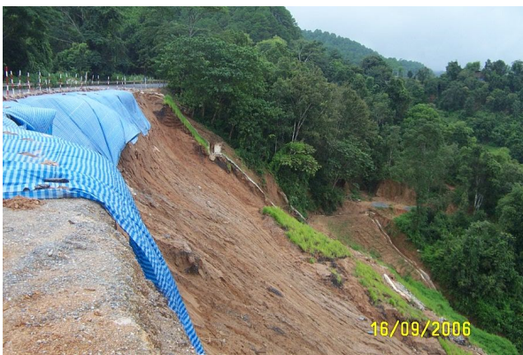
ภาพที่ 1 ร่องรอยดินถล่มหลังฝนตกหนัก บริเวณทางหลวงหมายเลข 108 ช่วงกม. 86+200 – 86+300 จังหวัดแม่ฮ่องสอน
