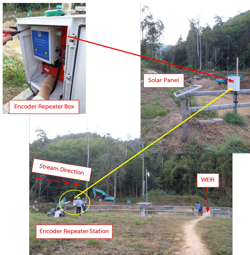
รูปที่ 5-8 สถานีส่งสัญญาณบริเวณฝายชลประทานห้วยน้ำแก้ว (repeater station) ที่มา : สุทธิศักดิ์ และคณะ (2558)
