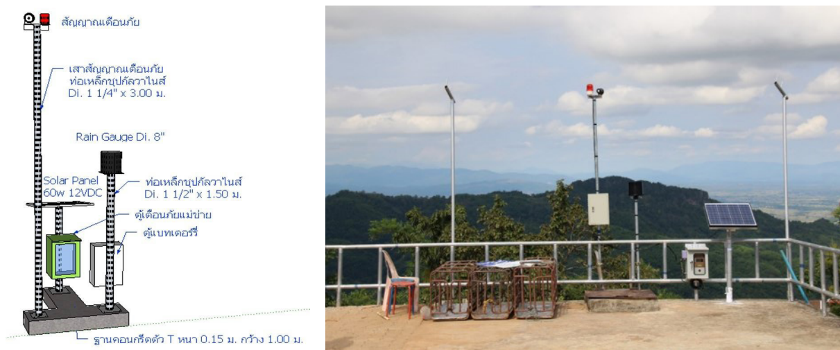
รูปที่ 26 สถานีตรวจวัดปริมาณน้ำฝนเผ่ากระวังและเตือนภัยดินถล่มในหมู่บ้านพื้นที่ต้นน้ำ
