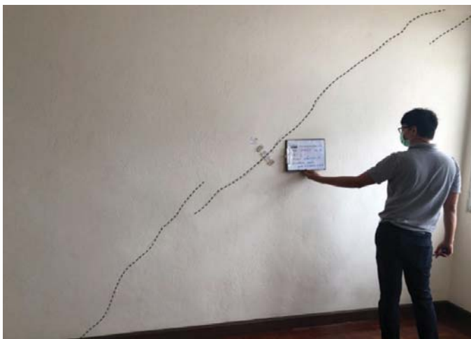
รูปที่ 2 การเก็บบันทึกข้อมูลลักษณะความเสียหาย ตำแหน่งที่เกิด และขนาดของความเสียหาย
