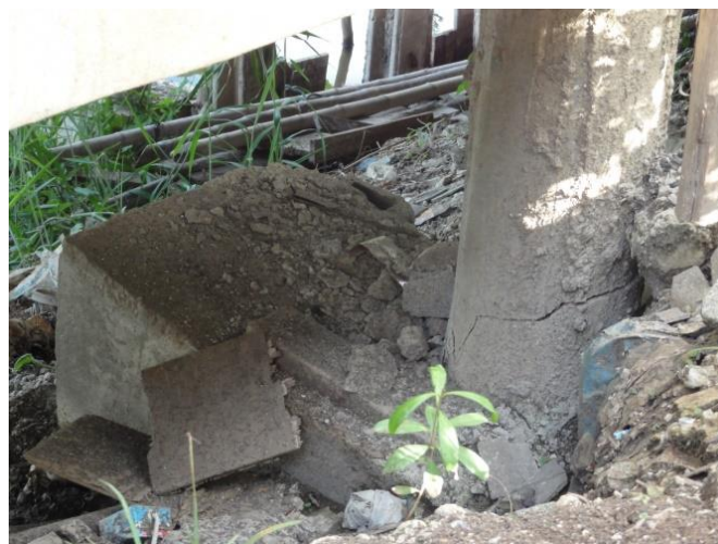
รูปที่ 10 การร้าวของเสาตอม่อเนื่องจากการเอียงศูนย์ของฐานราก
