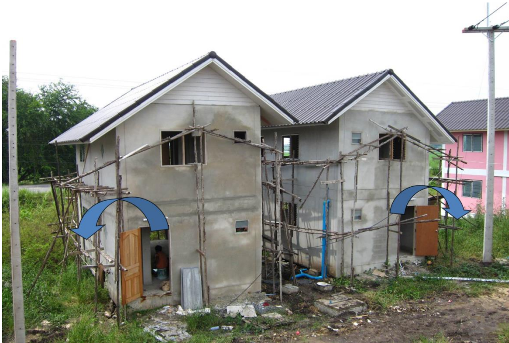
รูปที่ 4 บ้านเอียงไปทางที่มีน้ำหนักมาก เนื่องจากเสาเข็มสั้นและการกระจายน้ำหนักอาคารไม่เท่ากัน
