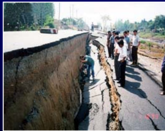
ตัวอย่างการพิบัติของคันถนนบนดินอ่อน (ข้อมูลจากกรมทางหลวงฯ)
