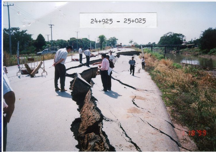
การพังทลายของถนนบนคันคลองรังสิต สาเหตุจาก Rapid Drawdown
