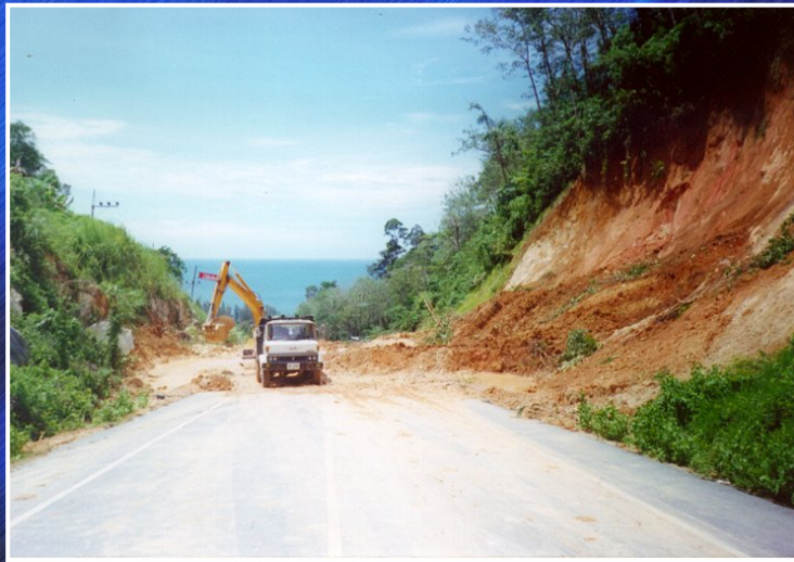
กรณีการพังทลายแบบ Toe Failure ของลาดตัดถนน
