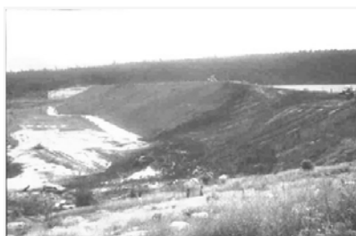
น้ำรั่วซึมผ่านฐานรากชั้นทราย หนา 15-20 เมตร
